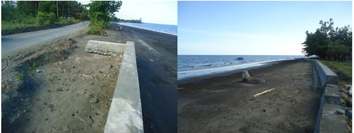
Gambar 7.11. Karakteristik Pantai Pandanwangi di Kabupaten Banggai (abrasi dan penanganann eksisting)
