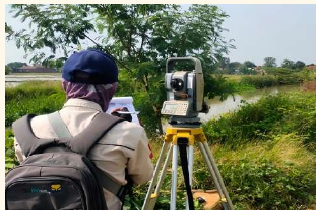
Rehabilitasi/Peningkatan/Modernisasi Jaringan Irigasi SS Jengkol Cs, SS. Pengkolan Cs, SS. Sukamandi Cs, SS. Beres Cs
