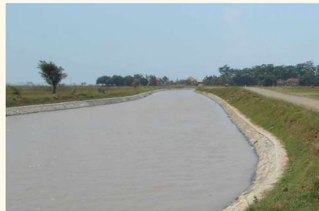
Rehabilitasi SS Sukamandi Cs, SS Jengkol CS, SS Gadung Cs; SS Rancabango Cs, SS Beres dan SS Macan Cs WISMP 2
