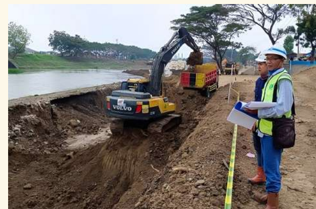
Non Regret Measures Di. Jatiluhur (Siphon dan Kantong Lumpur Salamdarma, Bendung Barugbug, Bendung Gadung)
