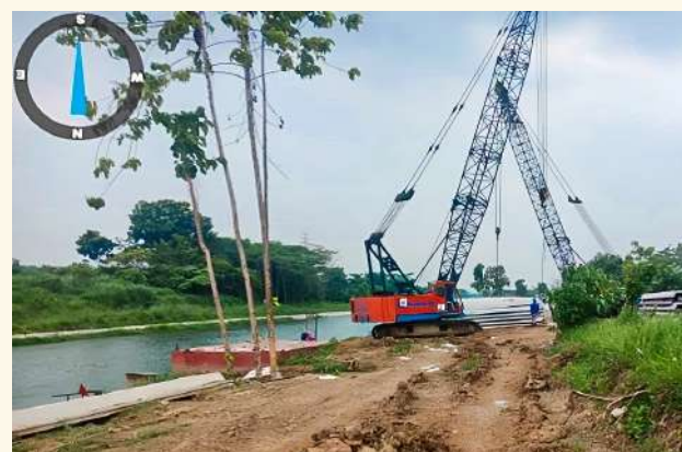
Rehabilitasi, Peningkatan dan Modernisasi Jaringan Irigasi SS. kamojing Cs, SS. Telar, SS. Barugbug Cs, SS. Tapen Cs, Sl. Tarum Timur Jawa Barat
