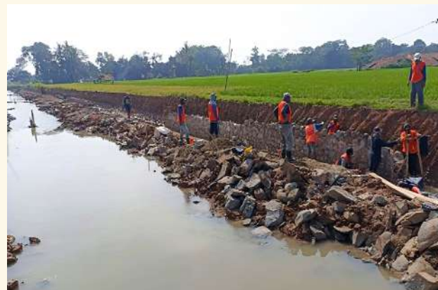
Rehabilitasi, Peningkatan dan Modernisasi Jaringan Irigasi SS. Kamurang Cs, SS Rancabango Cs, Sl Karang Toman
