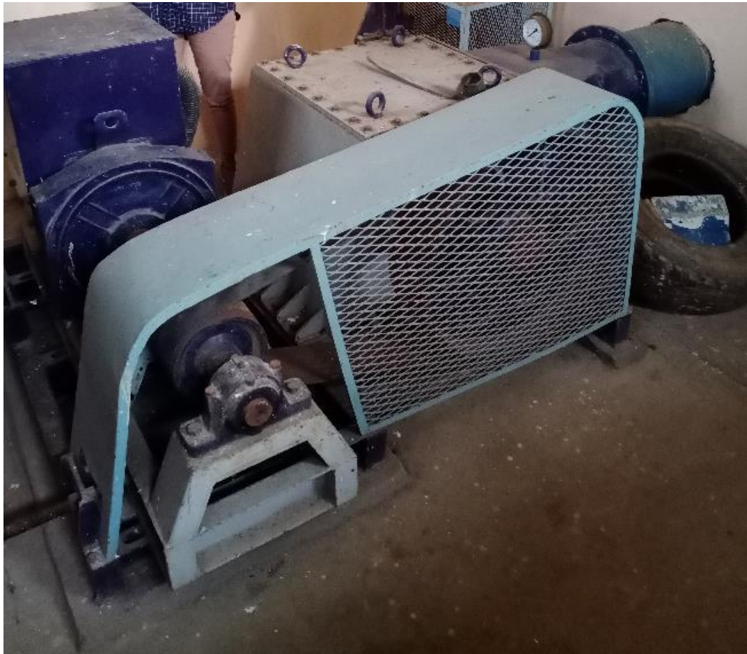
Papan nama bangunan dan turbin (berada dalam kondisi rusak)
