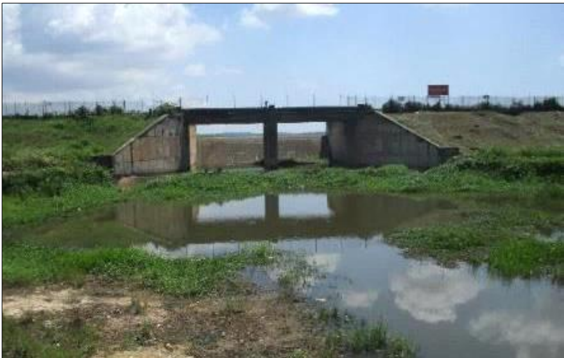
Gambar 2.26 Bangunan Pelimpah Bendungan Duriangkang
