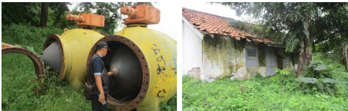
Gambar 4.13 Kondisi Aset yang Rusak di Bendungan Cacaban
