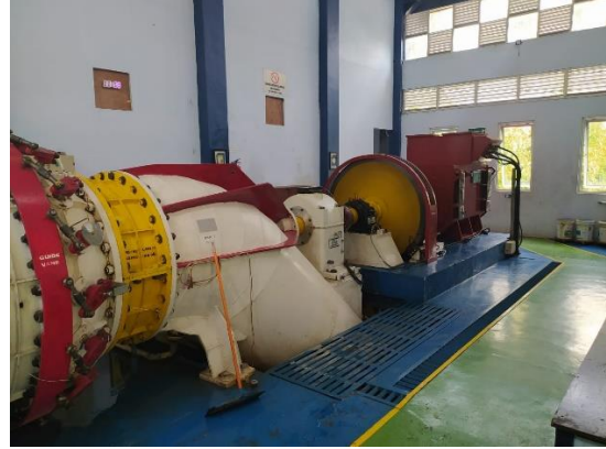
Foto 8. Turbin dan Generator PLTMH Semawung
