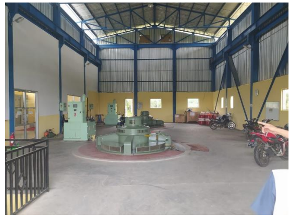
Foto 2. Power House PLTM Komering
