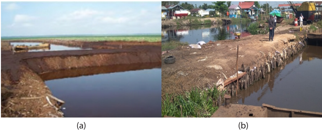
Gambar 6.22 Jenis dan Tipe Sekat dari Gambut yang Dipadatkan ( Compacted Peat ) di PT BNS Riau, Supervisi Deputi III BRG RI, 2019 Sumber: a) Deltares, b) Triadi, L. Budi, 2019 (PT Bumireksa Nusa Sejati, Riau)
