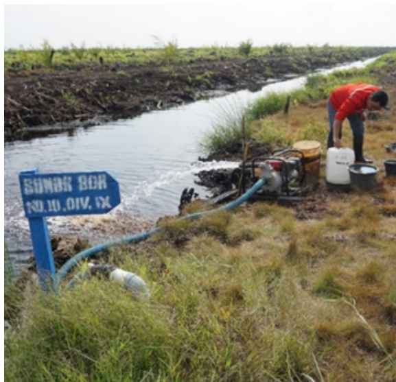
Gambar 6.26 Sumur Bor di PT GCG Sumatera Selatan, Supervisi Deputi III BRG, 2019 Kontributor foto: Budi L. Triadi
