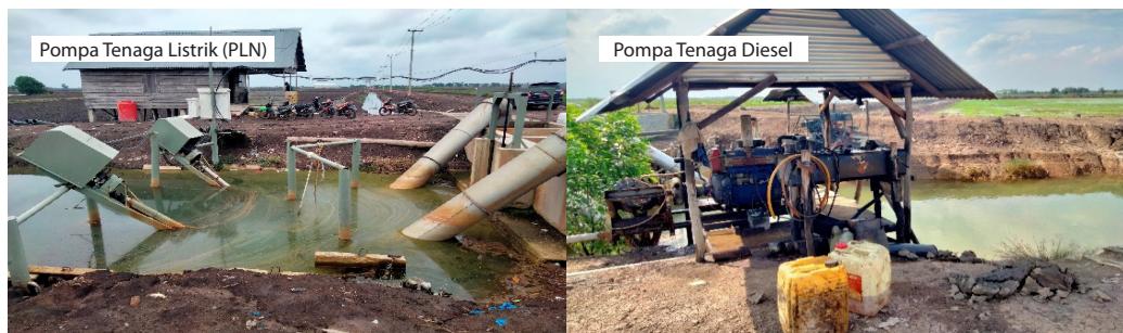
Gambar 6.40 Dua Jenis Pompa yang Digunakan dalam Sistem Polder PT BPS Sumber : Direktorat Pengairan dan Irigasi, Bappenas
